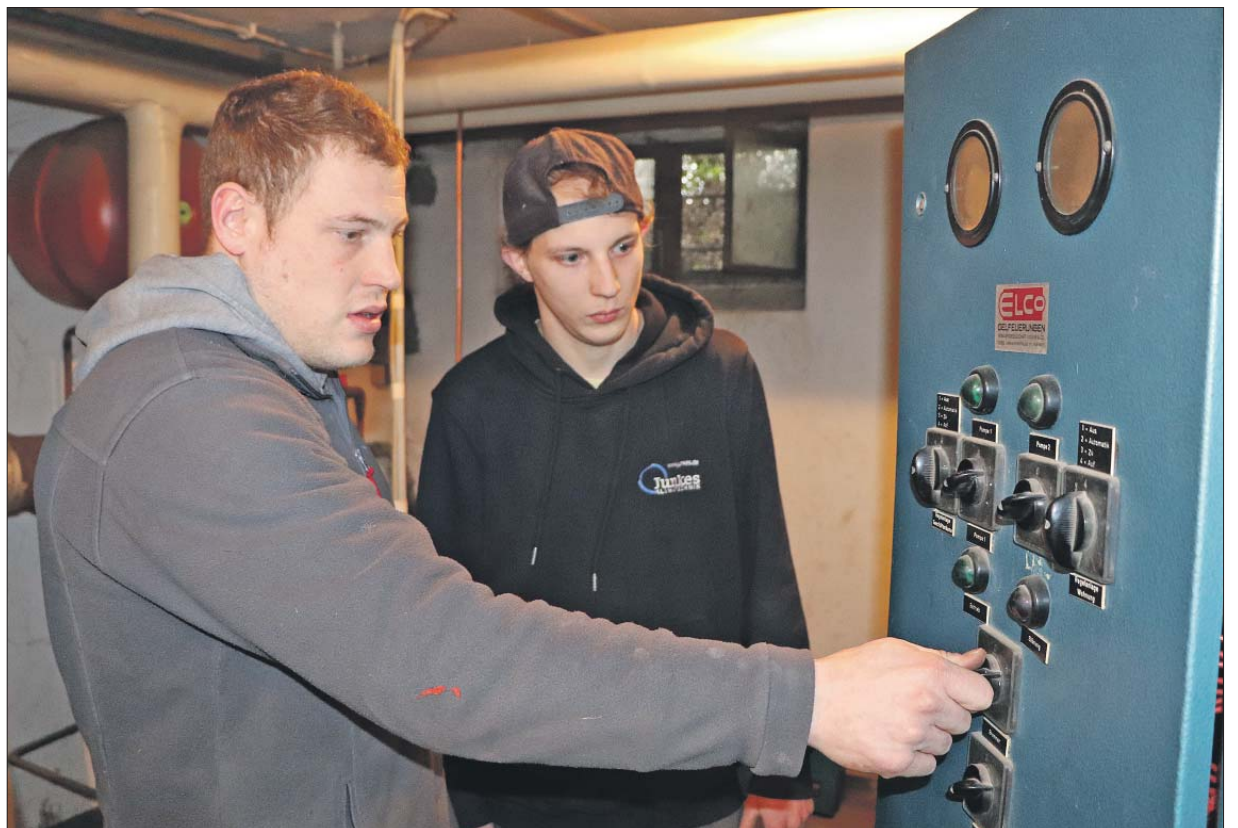
Knopf für Knopf. Azubi Andreas Jäckels (r.) schaut aufmerksam zu, als Philipp Hastert, Geselle bei der Firma Junkes, ihm die Funktion einer Heizanlage erklärt. Foto: Jobcenter Trier
