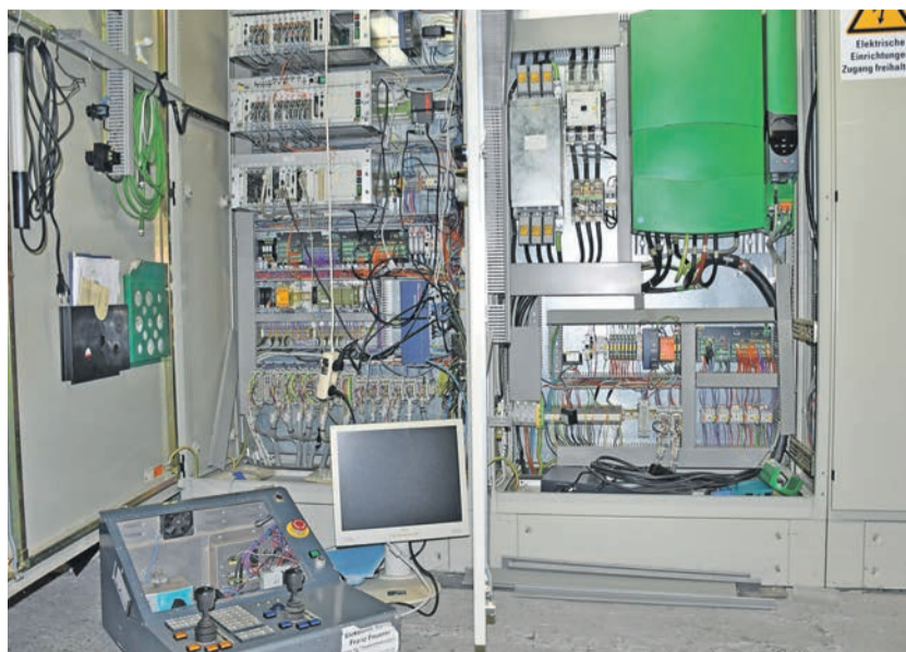
Kabelsalat. Dieser Teil der Bühnensteuerung wird erneuert, damit Aufführungen im Großen Haus auch weiterhin ohne Ausfälle der Podien und weiterer Elemente möglich sind. Foto: Presseamt/heb
