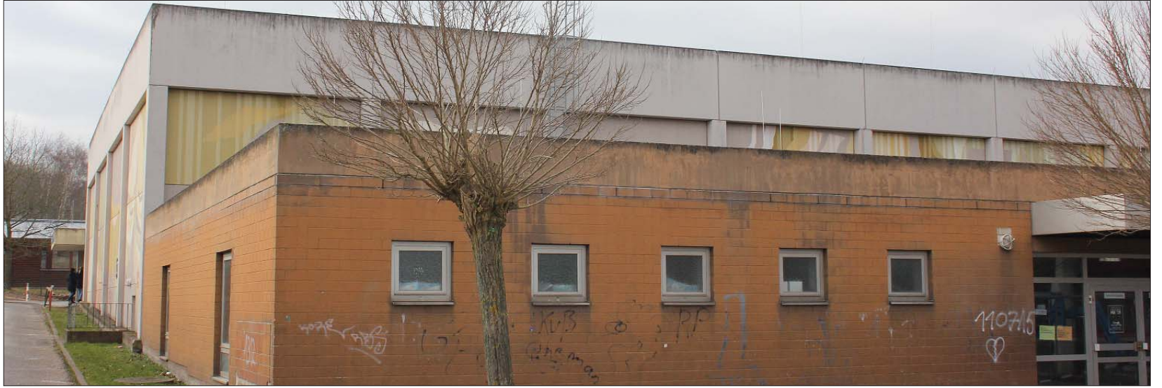
Ausgedient. Dank des neuen Förderprogramms rückt jetzt der Ersatzbau für die in den 70er Jahren errichtete Wolfsberghalle näher.
