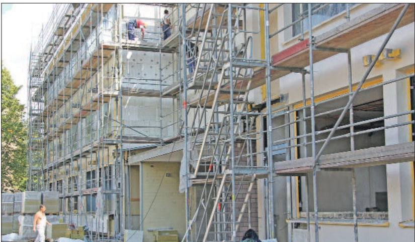
Kompletterneuerung. Nach der weitgehenden Entkernung des Schulgebäudes sind an der Gebäudesite Richtung Thyrsusstraße mittlerweile die ersten Fenster eingebaut. Gleichzeitig erhält die Fassade eine komplett neue Dämmung, die modernen Energiesparstandards entspricht. Foto: PA
