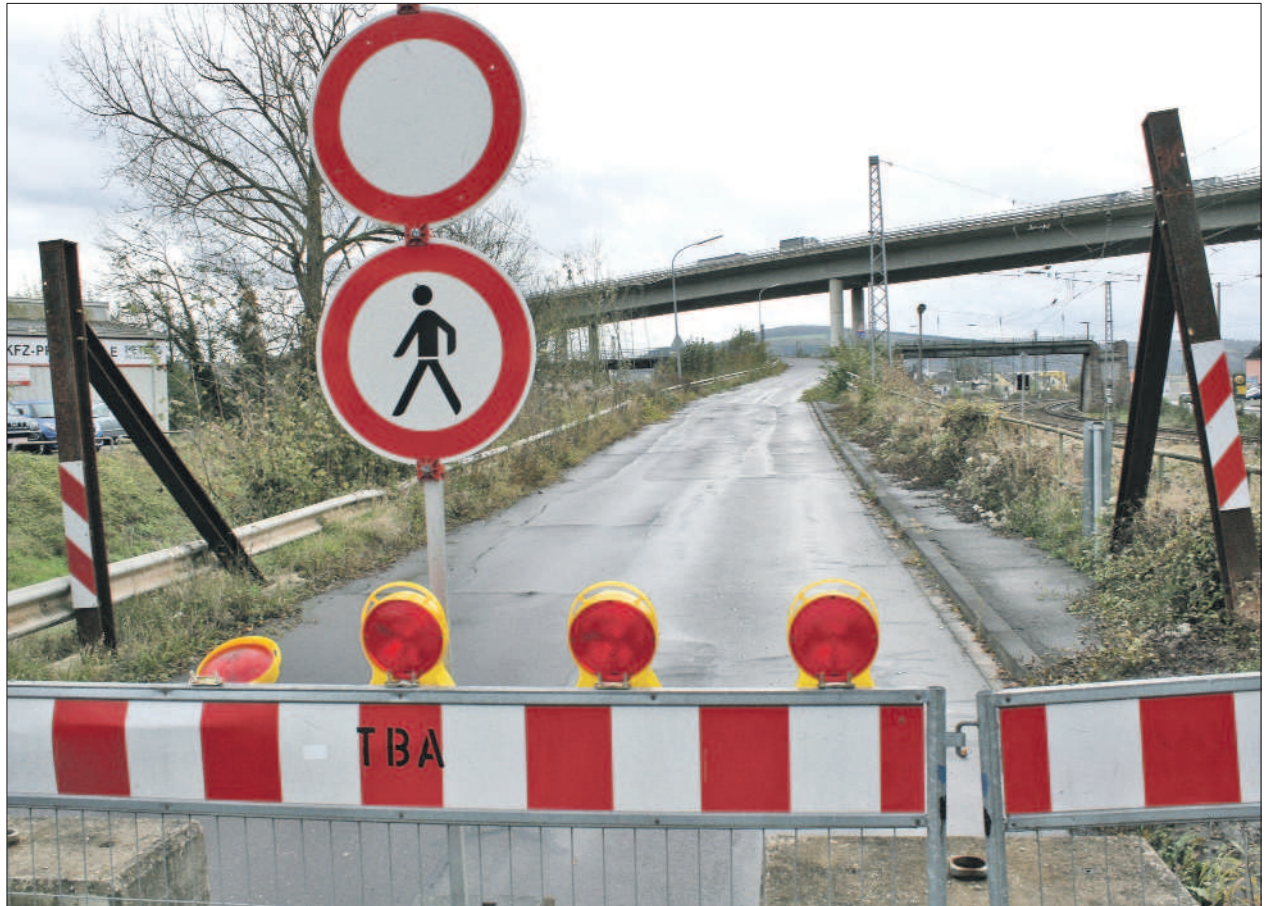
Kein Durchkommen. Die Auffahrt zur stark beschädigten Pfeiffersbrücke ist seit Juni aus Sicherheitsgründen gesperrt. Eine „Etage“ höher verläuft die Moselalbrücke der B 52. Foto: PA
