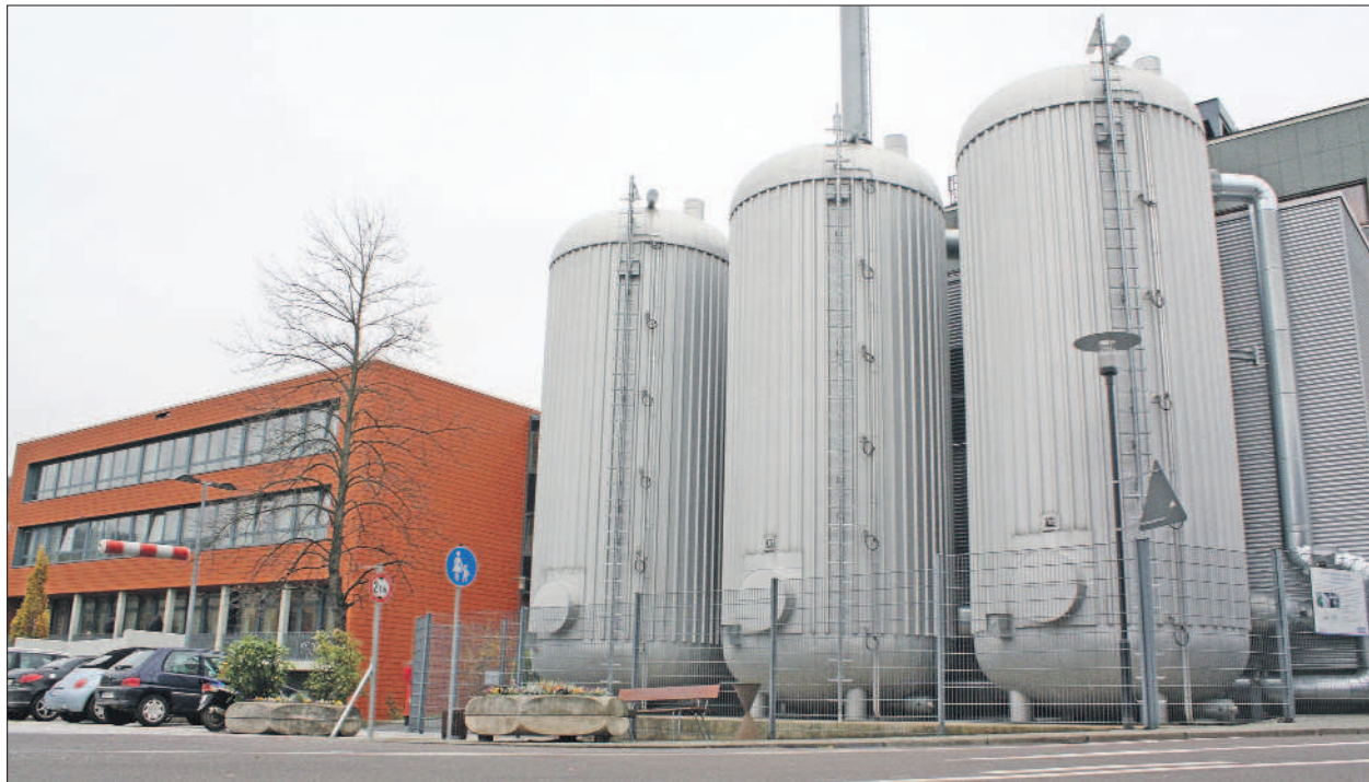
Ausgenutzt. Das 2009 gebaute Blockheizkraftwerk auf dem Gelände des Mutterhauses arbeitet nach dem Prinzip der Kraft-Wärme-Kopplung. Dadurch spart das Klinikum 50 Prozent CO 2 und 20 Prozent der Kosten für Wärmeenergie ein. Foto: PA
