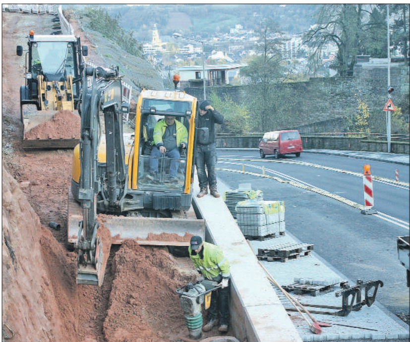
Anstieg. Die Arbeiten an der B 51 konzentrierten sich zuletzt auf die Herrichtung der Fuß- und Radwegverbindung zur FH. Foto: PA
