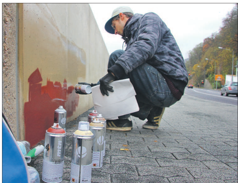
Sprayen erwünscht. Graffiti-Künstler Yuri Cancell arbeitet an der Bitburger Straße. Die neu errichtete Stützmauer wird mit Trier-Motiven aus der Spraydose gestaltet. Foto: PA
