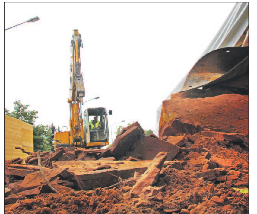
Felssprengung. 200 Kubikmeter roter Sandstein werden bei der ersten von drei Felssprengungen an der Bitburger Straße abgetragen. Ein Bagger zermahlt anschließend die einzelnen Brocken. Später werden 520 Tonnen Schutt abtransportiert. Mit dem Beginn der Vollsperrung ist die Großbaustelle an der wichtigen Einfallstraße Anfang des Monats in ihre „heiße Phase“ getreten. Auf dem Programm stehen die Schaffung einer zusätzlichen Fahrspur stadteinwärts, die Erneuerung der Fahrbahndecke und einer Stützmauer, die Sanierung der Napoleonsbrücke und die Schaffung einer neuen Geh- und Radwegverbindung zur Hochschule. Die weiträumige Umleitung wird gut angenommen. (15. Juni)
