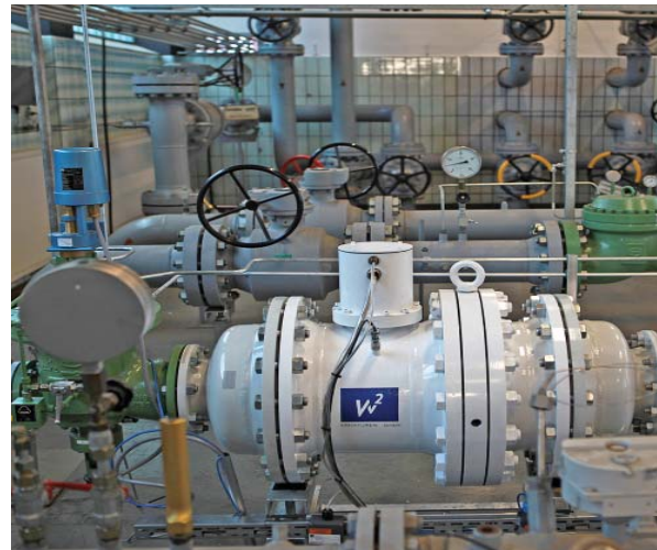
Vor Ort. Zum Erdgasnetz der Stadtwerke gehört unter anderem diese Regelstation auf dem Gelände an der Ostallee. Foto: Stadtwerke
