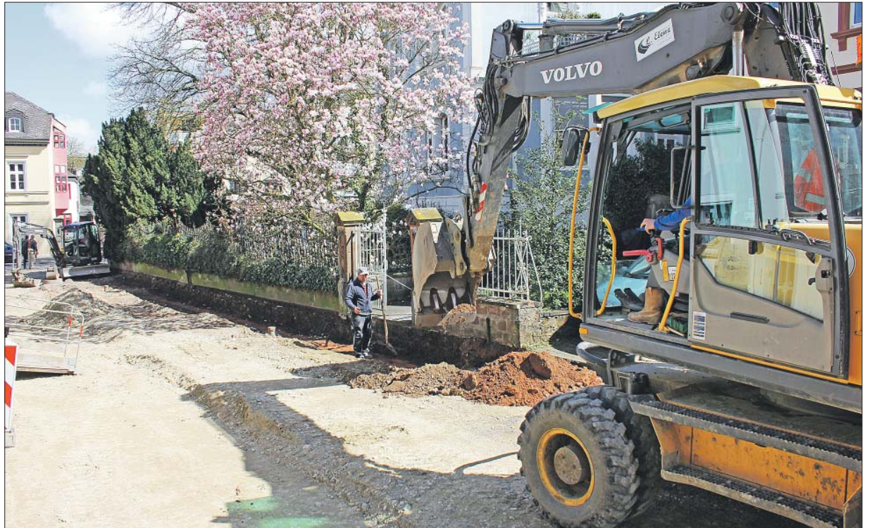
Erdbebung. Die Egbertstraße im Gartenfeld ist zurzeit gesperrt und wird bis Mitte Juni verkehrsberuhigt ausgebaut. Nach dem Abfräsen der Asphaltdecke waren Mitarbeiter der Firma Elenz Ende vergangener Woche mit Ausschachtungsarbeiten zum Wiederaufbau der Straße beschäftigt. Foto: Presseamt
