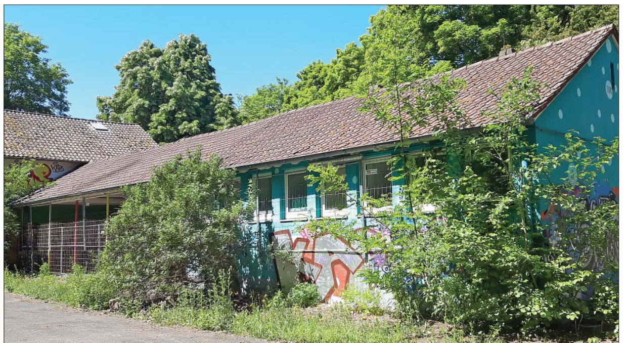
Dornröschenschlaf. Derzeit weist auf dem Gelände der Egbert-Grundschule noch nichts auf die bevorstehende Sanierung hin. Das Gebäude ist durch Sträucher ziemlich zugewuchert. Foto: Presseamt/PA
