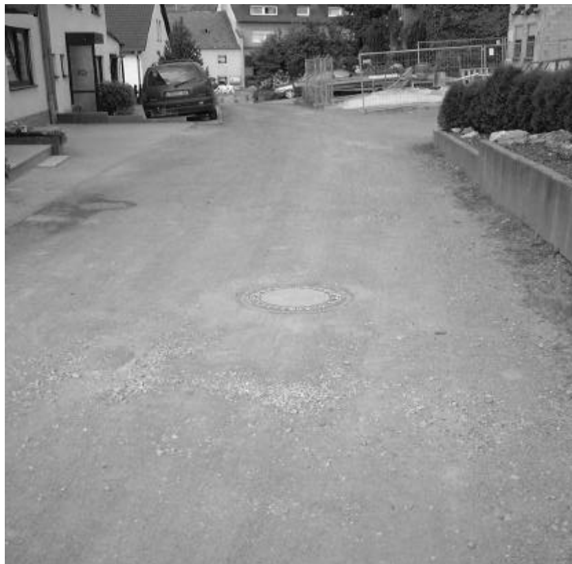
Abb. 26: Schlechter Straßenzustand der Franz-Rupp-Straße
