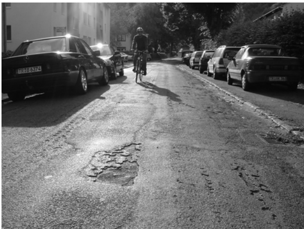
Bild 41: Zustand der Fahrbahndecke im Tempelweg
