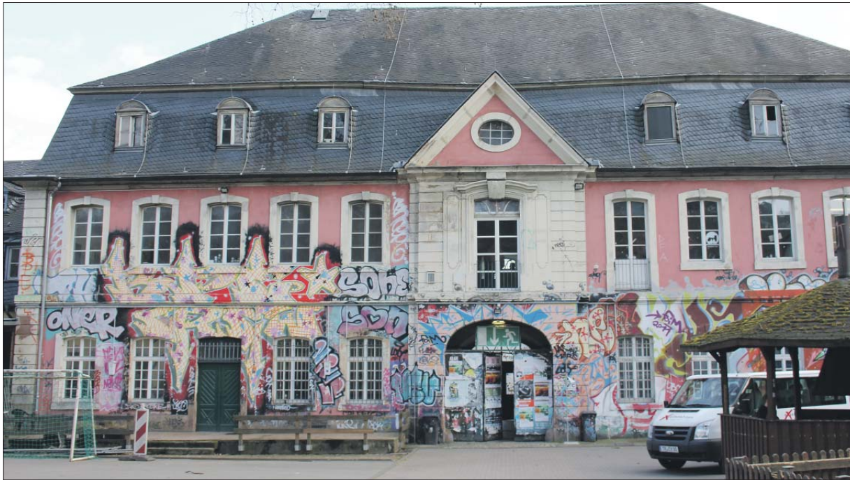
Auflagen. Das denkmalgeschützte Exhausgebäude kann derzeit wegen der baulichen Mängel nur eingeschränkt genutzt werden. In dem Komplex sind auch eine Kita und das Medienzentrum untergebracht. Foto: PA
