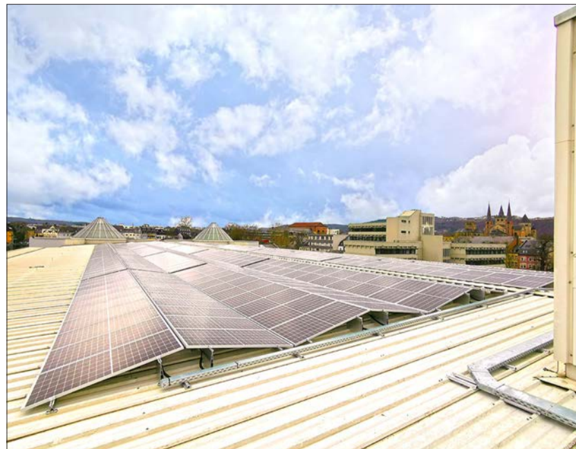
Die Sonne anzapfen. Die 636 Photovoltaik-Module auf dem Dach des Parkhauses produzieren jährlich 186.000 Kilowattstunden Strom. Foto: SWT
