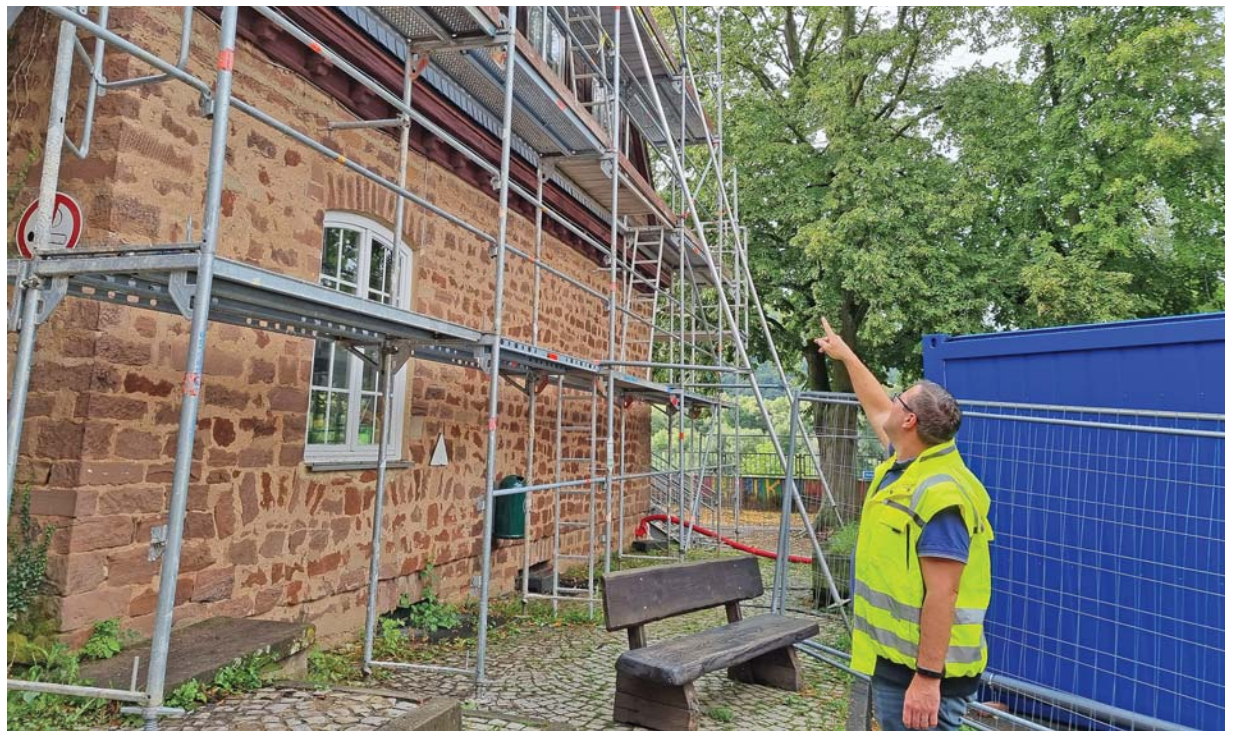
Historisches Gemäuer. Bauleiter Johannes Wallrich erläutert die Arbeiten an der Fassade und dem Dach der 1938 fertiggestellten Grundschule Pfalzel. Wegen der gleichzeitigen Toilettensanierung steht ein WC-Container im Hof. Foto: PA/pe
