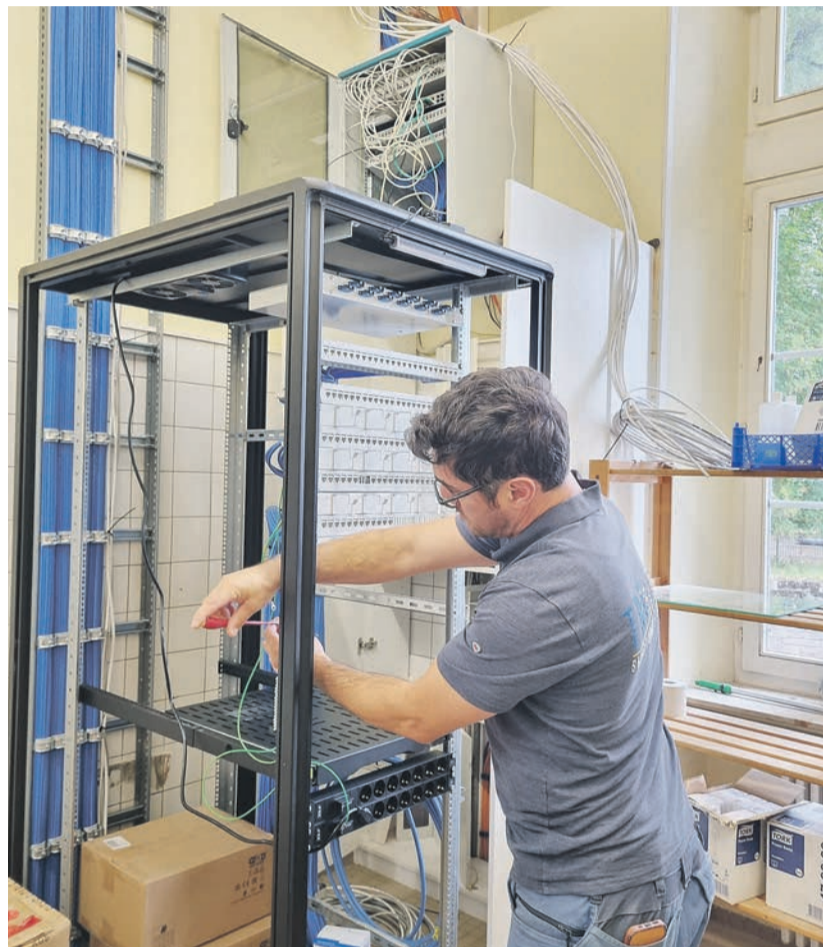
Erneuerung. Ercemil Güntepe, Inhaber der Firma Tri-Elektro, kümmert sich um Anschlüsse am neuen EDV-Schaltschrank der Grundschule Euren. Das ist eine wichtige Etappe zur Umsetzung des Digitalpakts. Foto: Presseamt/pe
