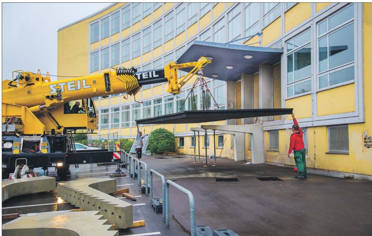
Klasse(n)Stufen. Das HGT bekommt einen neuen Treppenaufgang: Ein Schwerverkran hebt die 13,8 Tonnen schwere Plattform auf die bereits befestigten Betonstützen. Anschließend werden die im Vordergrund liegenden Aufleger der Stufen montiert. Foto: Presseamt
