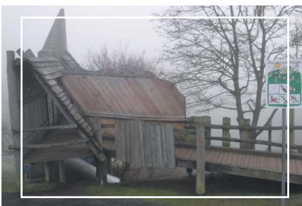
Der Spielplatz „Spielen am Hang“ im Petrispark wurde gesperrt, weil tragende Teile durch Fäulnissschäden marode sind. Eine Instandsetzung ist nach Einschätzung von StadtGrün Trier auch wegen des Alters des Geräts nicht mehr sinnvoll: „Der Spielbereich kann bedauerlicherweise in der Saison 2020 nicht genutzt werden. Er war eine Einzelanfertigung im Zuge der Landesgartenschau, so dass die Ersatzplanung beziehungsweise Beschaffung mehr Zeit in Anspruch nimmt als bei einem gängigen Spielgerät, das im Katalog bestellt werden kann“, ergänzt StadtGrün Trier. Foto: StadtGrün Trier
