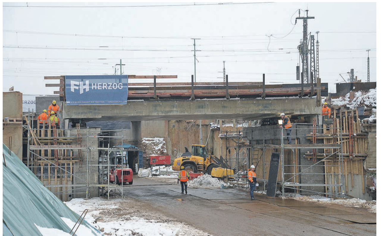
Überbau. Nach dem Einschub der 310 Tonnen schweren Eisenbahnbrücke über die Hafenstraße folgt die Feinjustierung an den Bolzen der Widerlager auf beiden Seiten. Foto: Presseamt/kg
