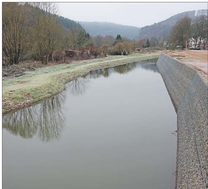
Stilles Wasser. Wichtige Voraussetzung für den Bau der Umgehungsstraße in Ehrang war die Verlegung des Mühlengrabens, der jetzt durch ein neues Bett fließt. Die 60 Grad steile Böschung zur künftigen Bundesstraße (rechts) wurde mit Metallkörben und Steinschüttungen befestigt. Foto: PA
