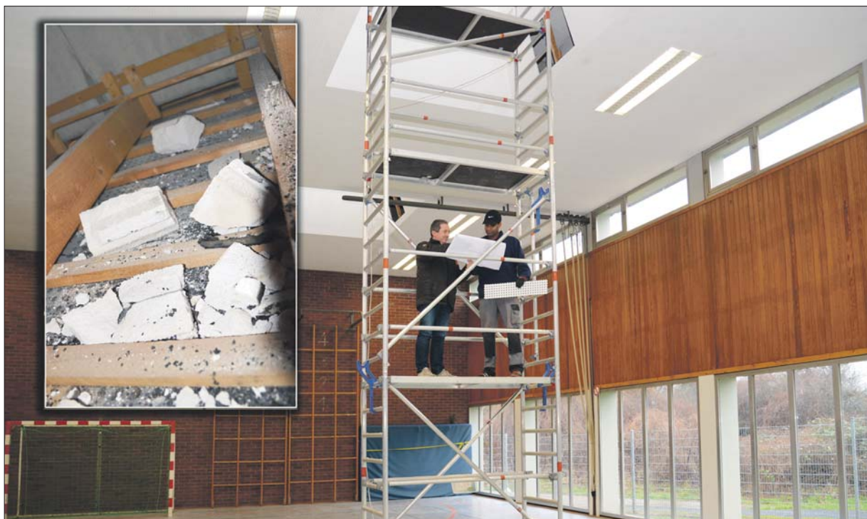
Dicke Brocken. Andreas Bayer (l.) und Sammy Habte begutachten die abgehängte Decke der Bezirkssporthalle Feyen. Der Blick in die Deckenkonstruktion (kl. Bild) zeigt die massiven Schäden in der Bausubstanz. Fotos: PA/Büro I+T
