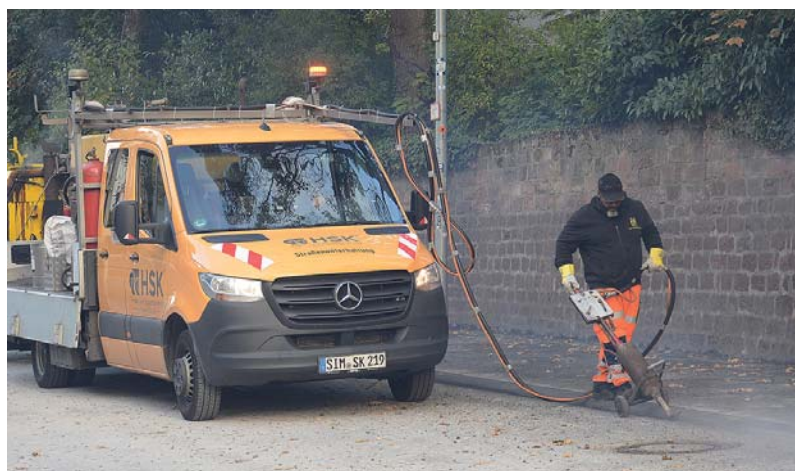
Endreinigung. Mit einem Spezialgerät, das Temperaturen bis 800 Grad erzeugt, säubert ein Bauarbeiter am Montagmorgen die Fugen auf dem fertigen Belag der Olewiger Straße. Anschließend wird dann die endgültige Fugenmasse eingefüllt. Foto: Presseamt/pe
