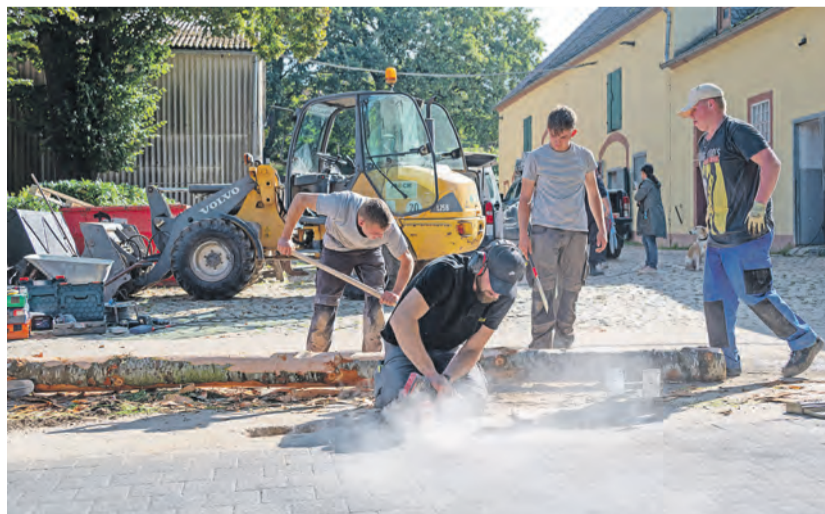
Mit schwerem Gerät. Im Rahmen der TAT-Woche hat die Firma Mock dem Reitverein Trier einen neuen Anbindeplatz für Therapiepferde samt barrierefreiem Zugang errichtet. Foto: Ehrenamtsagentur/Harald Tittel
