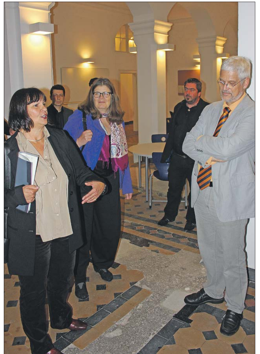
Schulbesuch. AVG-Leiter Bernhard Hügler, Bürgermeisterin Angelika Birk und Beigeordnete Simone Kaes-Torchiani (v. r.) tauschen sich im Foyer des Klosterbaus über die Sanierungsmaßnahmen aus. Der beschädigte Fliesenboden wird in den Herbstferien instandgesetzt. Foto: PA
