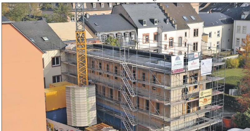
Zweite Phase. Nach dem Spatenstich für den Erweiterungstrakt der Kinder- und Jugendpsychiatrie im Mai steht der Rohbau. Nun läuft der Innenausbau. Die Fertigstellung ist für Oktober 2020 geplant. Foto: Mutterhaus
