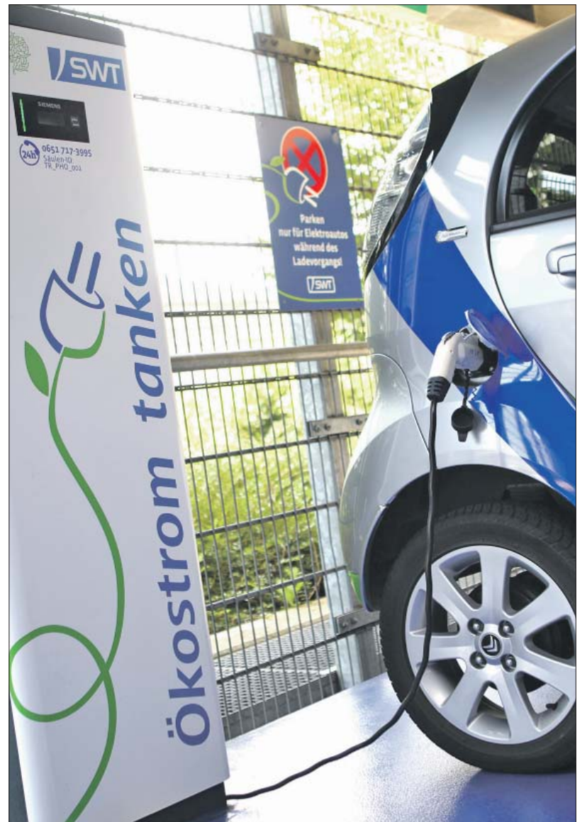
Lade-Parkplatz. Eine wichtige Rolle im Netz der SWT-Ladestationen spielen die eigenen Parkhäuser, darunter in der Ostallee. Für die Zukunft wird darüber nachgedacht, die Masten der Straßenbeleuchtung zu nutzen, um dort zusätzliche Ladestationen anzudocken. Die Kunden können sich auch individuell zu den Angeboten für Elektromobilität beraten lassen. Fotos: Stadtwerke
