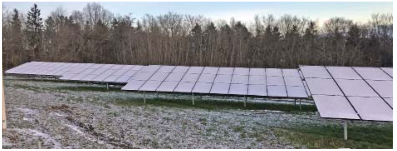
Sonnenhungrig. Die rund 6100 Solarmodule sollen jährlich rund zwei Millionen Kilowattstunden Ökostrom erzeugen. Damit können knapp 600 Musterhaushalte versorgt werden. Foto: SWT
