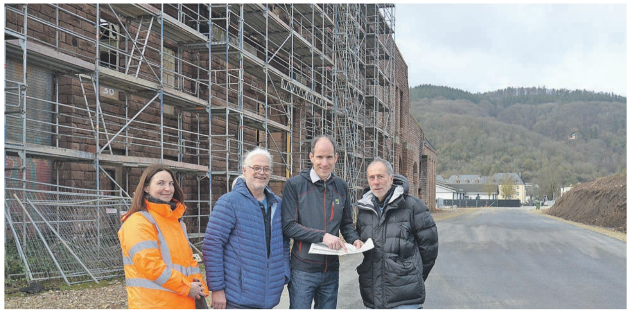
Treffen. Die provisorische Zufahrt zum Edeka-Markt verläuft entlang der Nordfassade der früheren Lokrichthalle. Antoine Feidt (Geschäftsführer TW Project, r.), Bernhard Hügler (stellvertretender Ortsvorsteher, 2. v. l.), Dezernent Thilo Becker (2. v. r.) und dessen Mitarbeiterin Sandra Klein (l.) besprechen die neuen Verkehrsbeziehungen. Foto: PA/kiq
