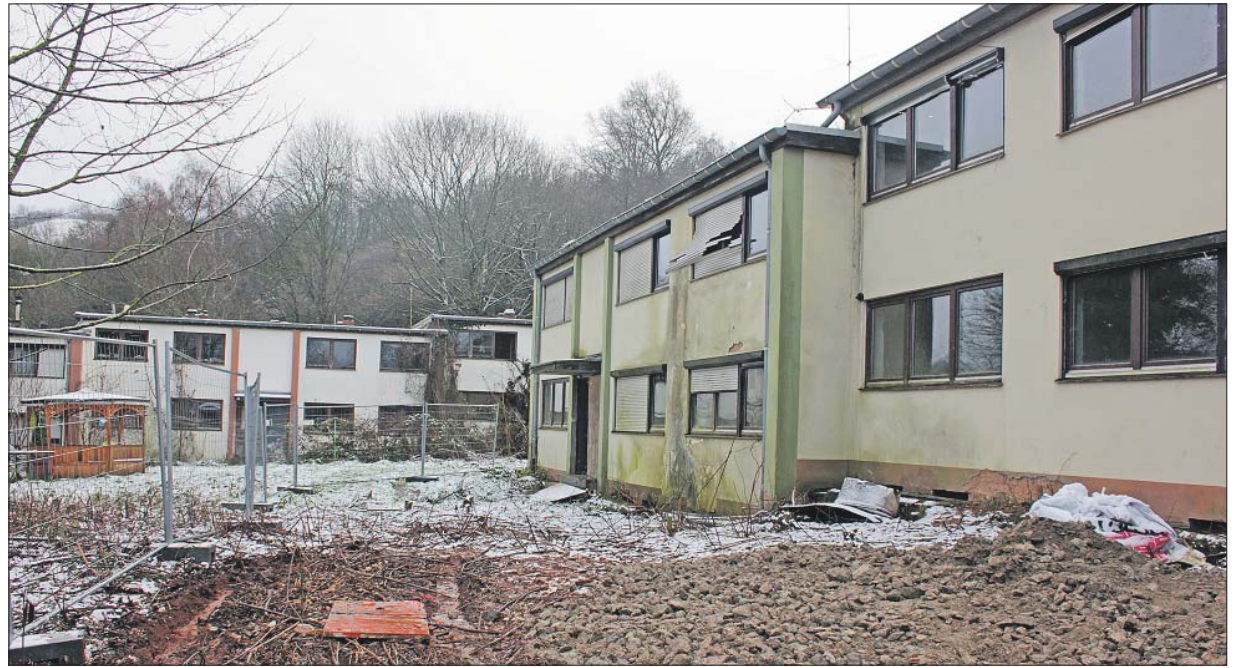
Verfall. Das seit Jahren unbewohnte Gebäude Riverisstraße 52/54 (rechts) steht kurz vor dem Abriss und wird zur Zeit leergeräumt. Foto: Presseamt
