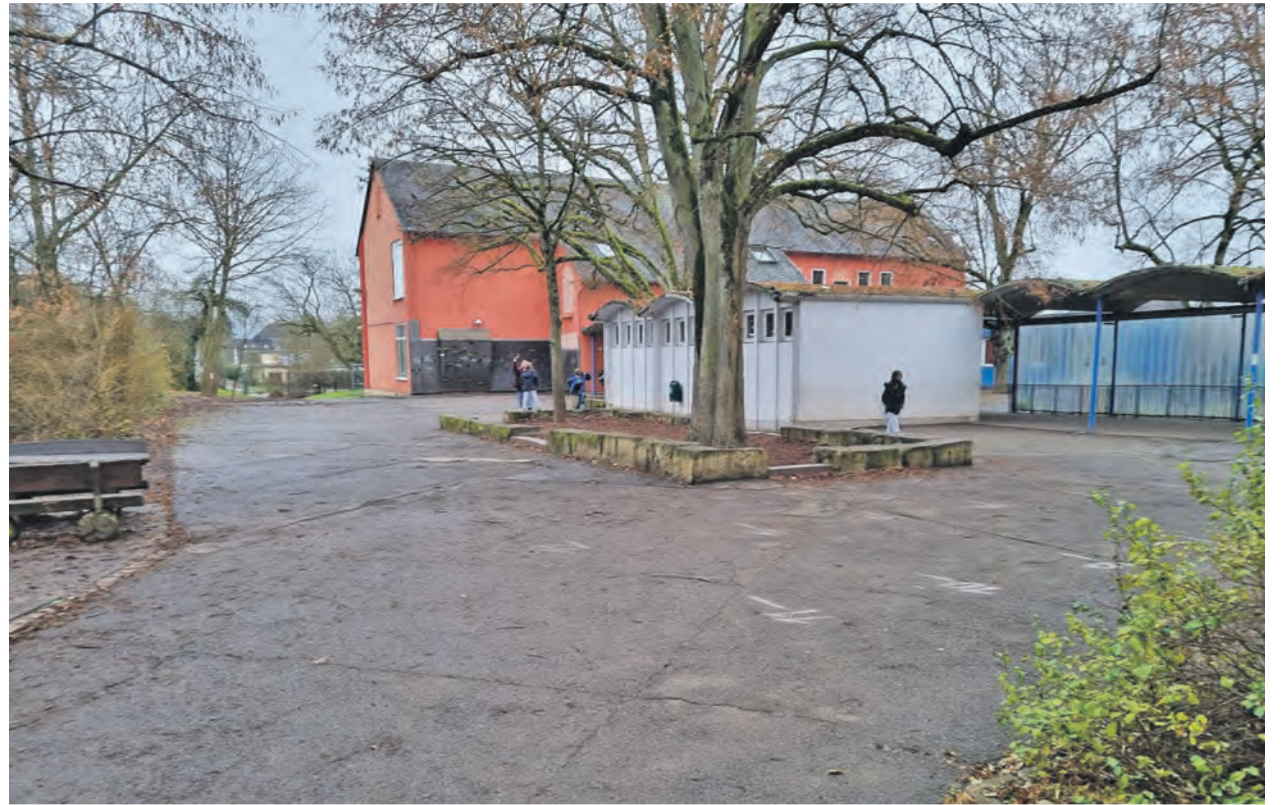
Handlungsbedarf. Der Schulhof im Stadtteil Heiligkreuz ist mit den großflächigen Schäden am Asphaltbelag kein Einzelfall. Die Neugestaltung soll auch die ökologische Qualität der Freiflächen verbessern. Foto: Presseamt/pe
