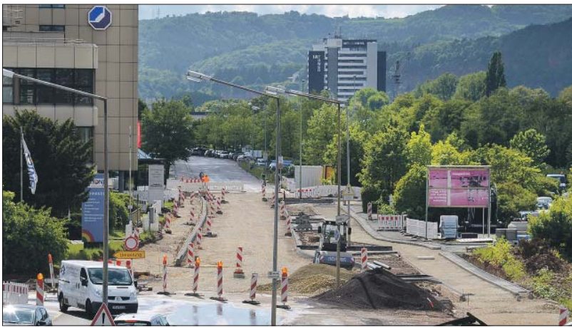
Baugebiet. Einen Monat früher als geplant beginnt beim Großprojekt „Erneuerung Loebstraße“ die zweite Bauphase. Dabei wird der Abschnitt zwischen der Pfälzer Eisenbahnbrücke und der Einmündung Ohmstraße (im Bild vorne links) ausgebaut. Anfang März war das Projekt mit dem ersten Bauabschnitt von 580 Metern Länge gestartet. Dieser Abschnitt kostet zwei Millionen Euro. Insgesamt ist die Ausbaustrecke 1,4 Kilometer lang. Nicht nur die Bedingungen für Autofahrer sollen verbessert, sondern auch die Interessen von Radlern und Fußgängern berücksichtigt werden. (19. Mai)
