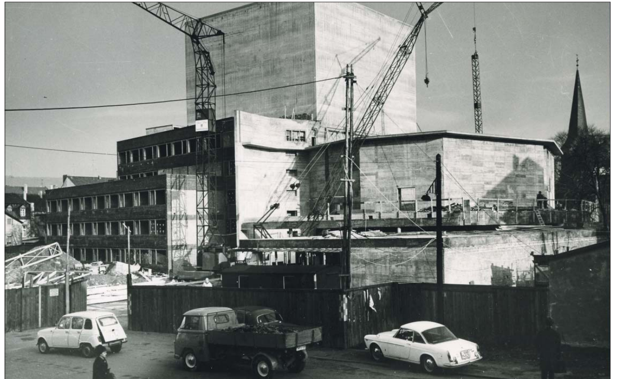
Baustelle. Das in den 60er-Jahren erbaute Theatergebäude am Augustinerhof ist mittlerweile marode und muss saniert werden. Foto: Stadtarchiv
