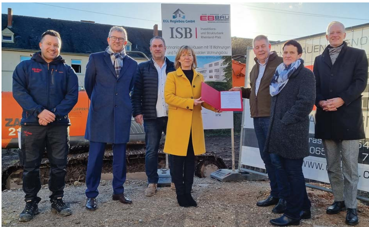
Wichtige Etappe. Finanz- und Bauministerin Doris Ahnen (Mitte) überreicht den ISB-Förderbescheid auf der Baustelle in Trier-West an das Investorenehepaar Ursula und Thomas Arndt (2. und 3. v. r.). Mit vor Ort sind außerdem Emrah Bayindir (links) und Patrick Lamberti (3.v. l.) als Vertreter der beteiligten Baufirmen, ISB-Vorstandssprecher Ulrich Dexheimer (2. v. l.) und Oberbürgermeister Wolfram Leibe. Foto: Presseamt/pe
