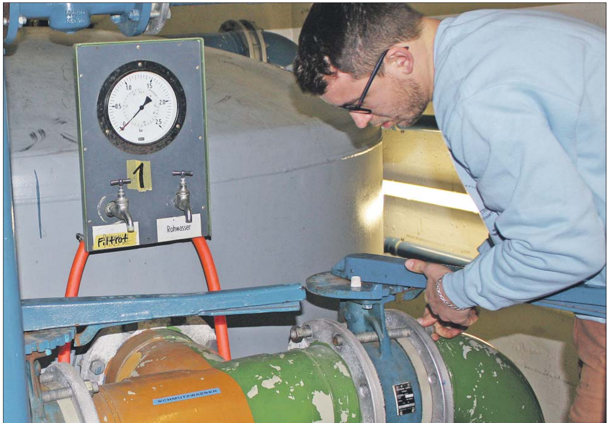
Vorsorge. Damit zum Saisonstart alles funktioniert, muss Schwimmmeister Thomas Schmitt die Wasseraufbereitungstechnik im Nordbad auch in den Wintermonaten regelmäßig warten. Foto: Presseamt
