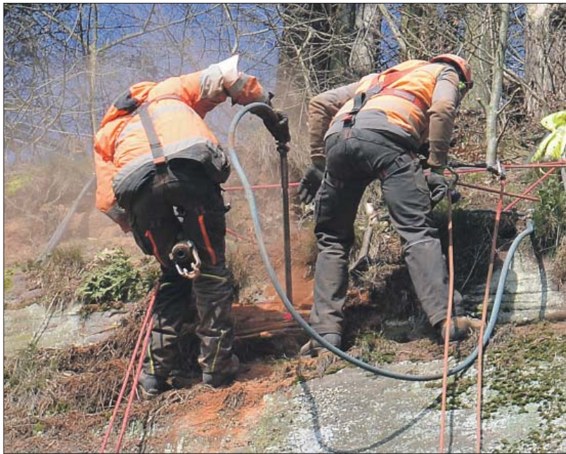
Luftiger Arbeitsplatz. Zwei Bauarbeiter blasen an der Oberkante der Wand die gerade gebohrten Löcher für die Felsnägel frei.
