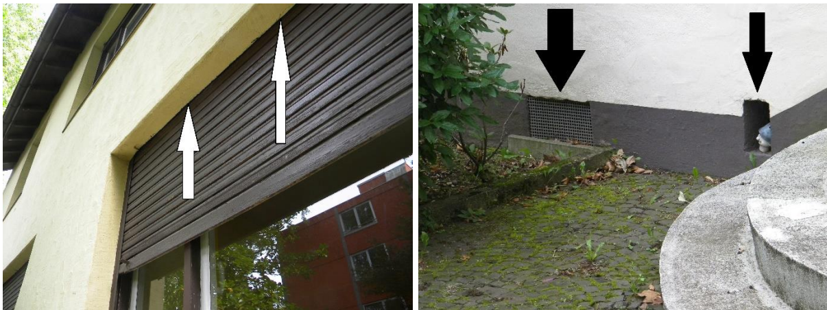
Abb.: möglicher Einflug an Rollladenkasten Abb.: verschlossene Kellerfenster
