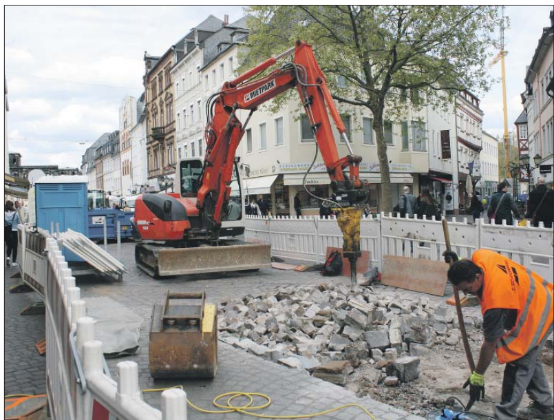
In der Simeonstraße läuft seit Montag vergangener Woche der nächste Abschnitt der aufwendigen Erneuerung des Pflasters. Die alten Steine werden in der Fußgängerzone mit einem Baggermeißel herausgelöst. Die Bauarbeiten dauern in mehreren Teilabschnitten bis November. Foto: Presseamt
