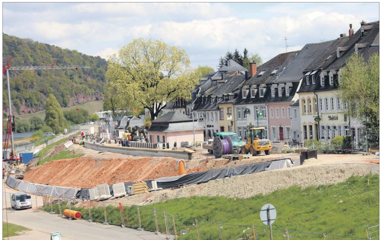
Mammutprojekt. Die Arbeiten am Zurlaubener Ufer sind nach wie vor in vollem Gange. Als eine der nächsten großen Maßnahmen wird eine Freitreppe von der Deichkrone zur Uferpromenade gesetzt. Foto: Presseamt
