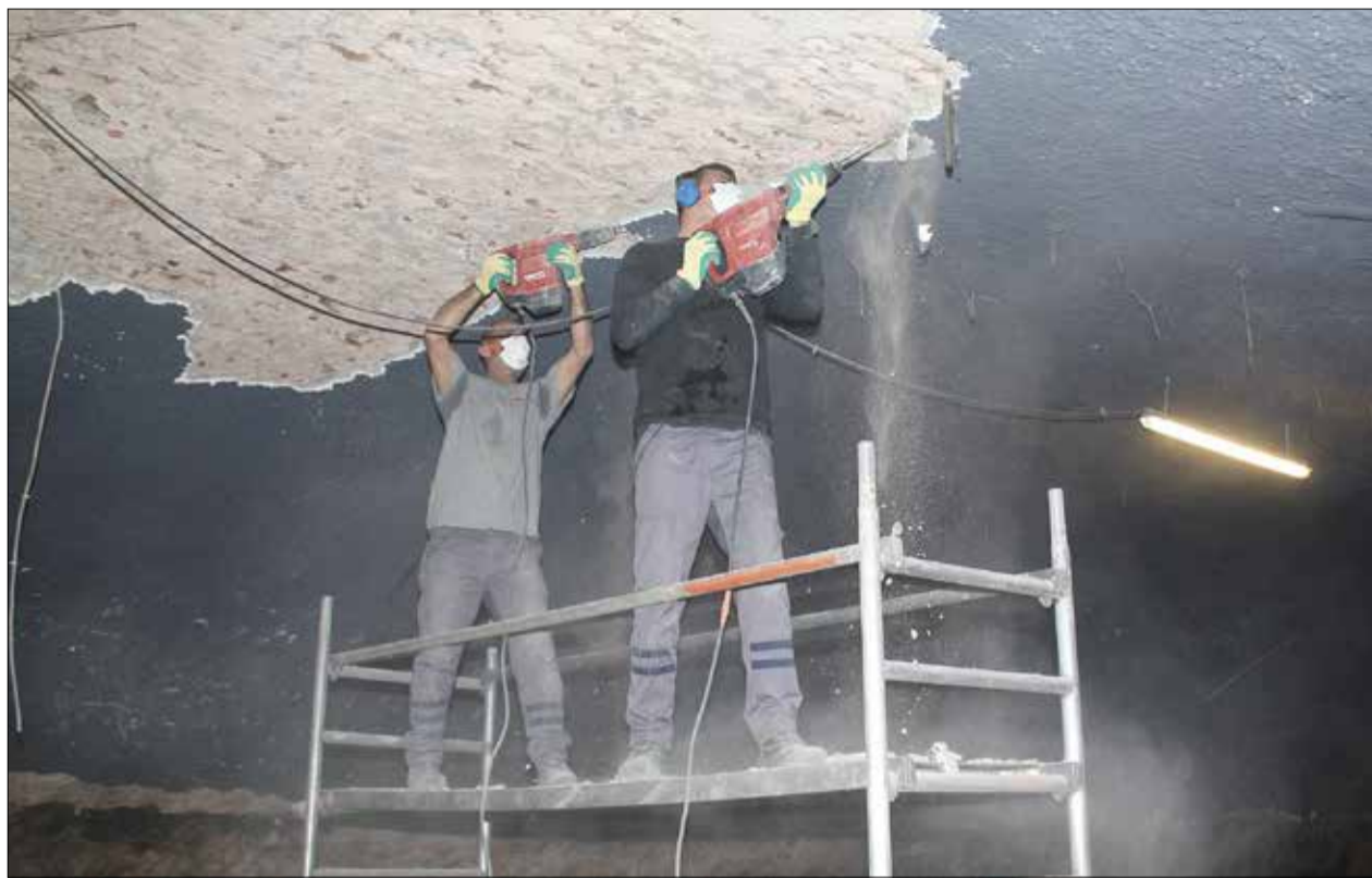
Im Untergrund. Das Exil, in dem früher zahlreiche große Konzerte stattfanden, ist derzeit eine einzige große Baustelle. Zwei Arbeiter entfernen den schwarzen Anstrich von der Decke, hinter dem sich immer wieder Schimmel gebildet hat. Foto: Presseamt/pe
