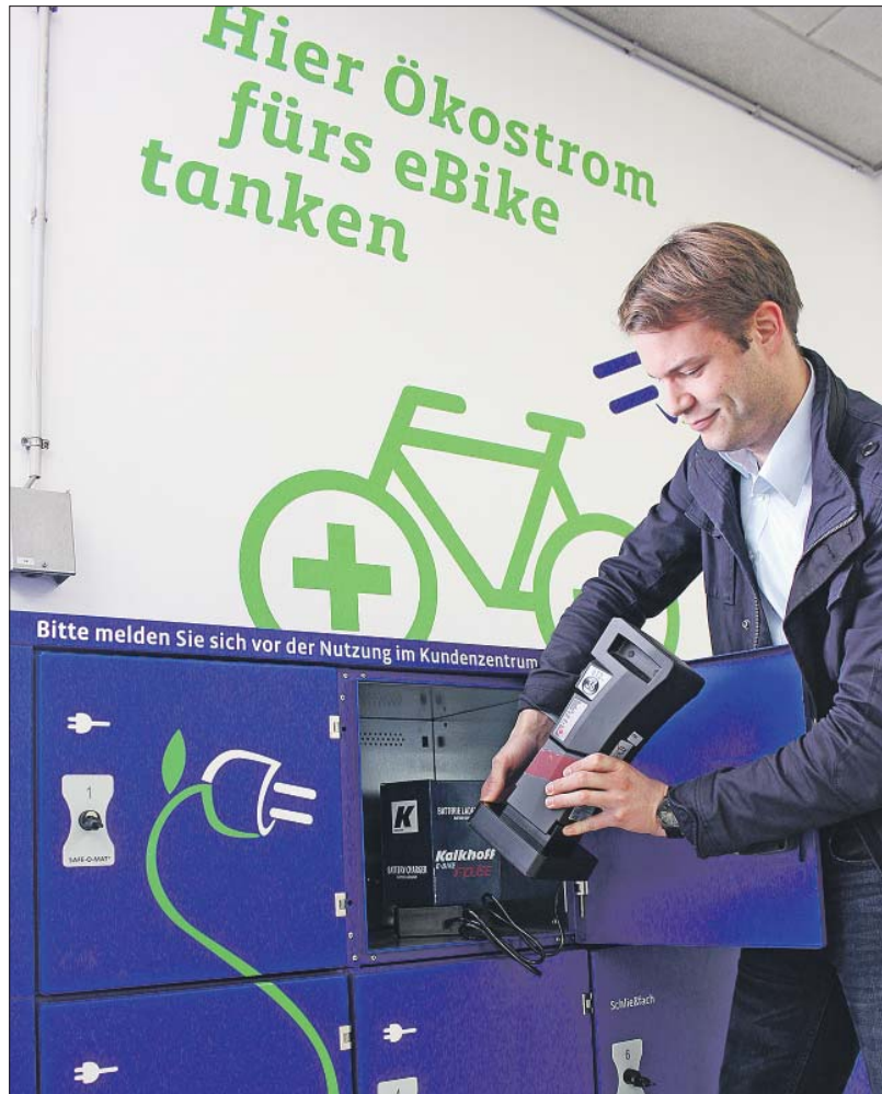
Stromkasten. SWT-Projektmitarbeiter Andreas Kohl demonstriert die Funktionsweise der neuen Ladeboxen für E-Bike-Akkus im City-Parkhaus. Foto: PA
