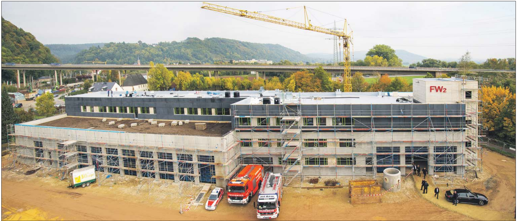
Von oben. Aus dieser Perspektive ist der Rohbau des Brand- und Katastrophenschutzentrums nur selten zu sehen. Unser Fotograf ließ sich dafür auf einer Drehleiter im Korb 30 Meter hoch in die Luft fahren. Fotos: Dieter Jacobs
