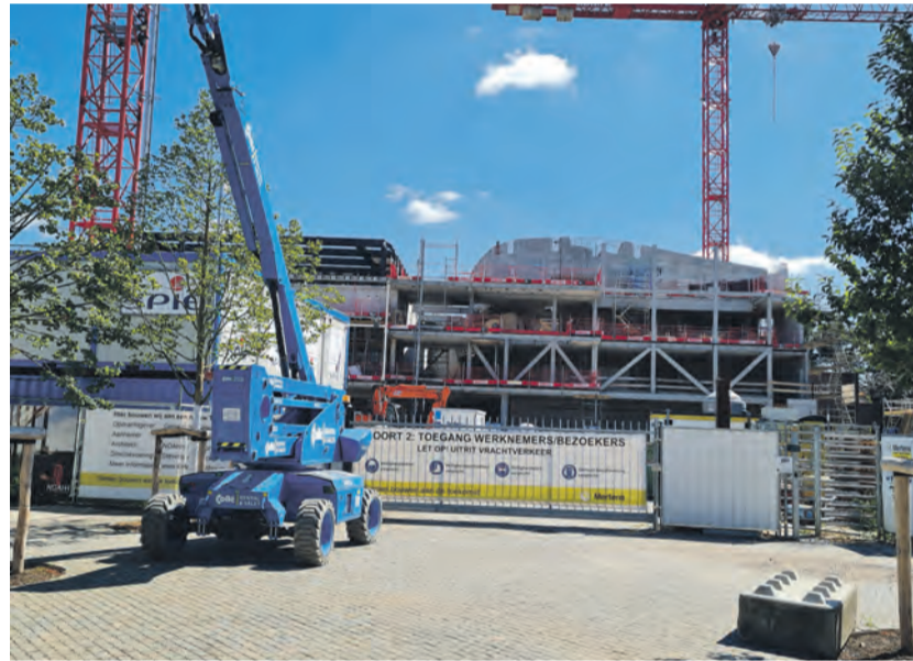
Bauarbeiten. Das alte Theater im Herzen der Stadt wird durch einen Neubau ersetzt. Fotos: Markus Nöhl/Elisa Limbacher
